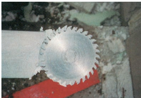
Abb. 18 - Sanierungsmaßnahme an einer zweischaligen Porenbetonsteinwand mit einem doppelseitigen Sägeblatt an einem 5 Meter langen Schwert [7.14]
